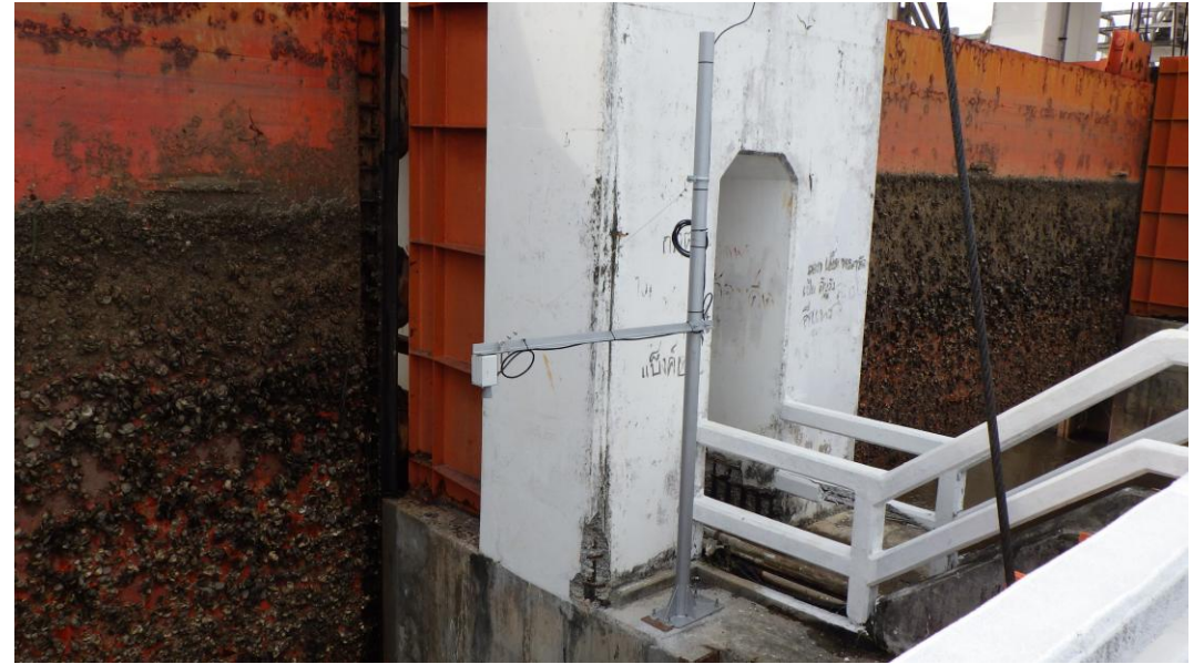
図表6 設置した超音波水位計
